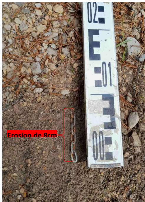
Chaîne d'érosion station 1 Le 2 décembre 2024
